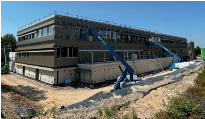
De inpandige gymzalen inclusief leslokalen gezien vanaf de achterzijde van het gebouw.
